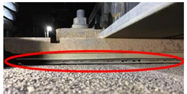
図2 仙台駅P63号 HMPの劣化状況
