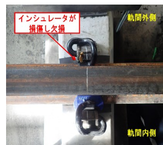
図 5 試験後のレール締結装置
