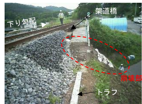
図5 盛土dの災害発生状況
