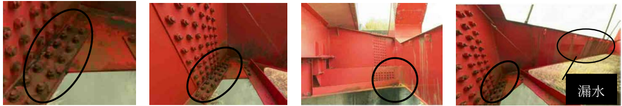
写真-4 パノラマカメラ撮影による格点部のボルト腐食確認 ※○は同一箇所
