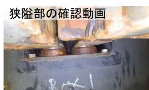
(ウ) ビーム型伸縮装置内部
