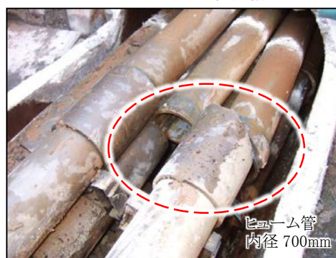
図 2 通信用ヒューム管内の管の地震被害事例
