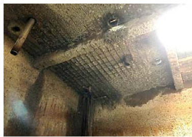
写真-2 補修前(気層部)
