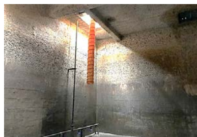
写真-1 補修前(全体)
