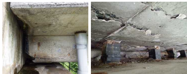
写真-1 漏水状況
