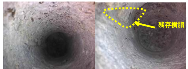
写真-4 再穿孔した孔壁の状況
