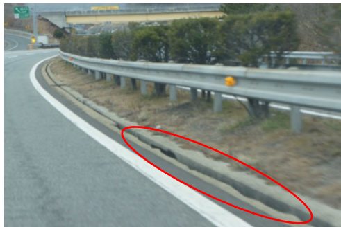
写真1 円形水路の損傷状況（赤囲み部）
