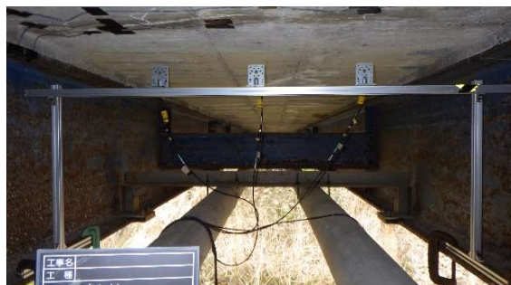
写真4 レーザー変位計設置架台
