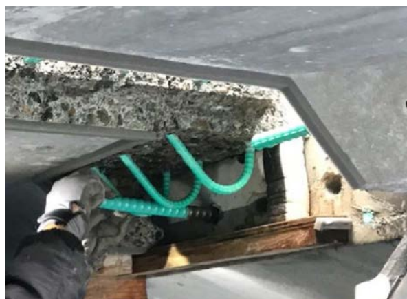
図-6 床版切欠き状況写真
