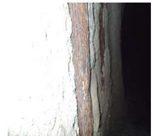
写-2 鋼製支保工の錆
