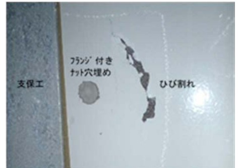
写真1 ひび割れ発生状況
