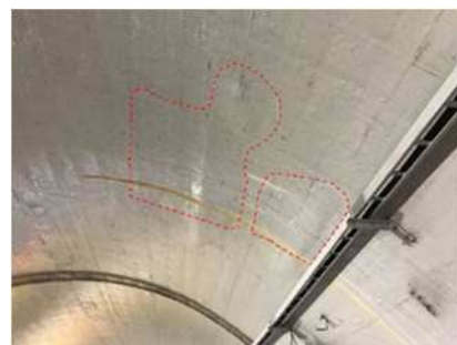
写真-1 シート工の浮き (赤枠部)
