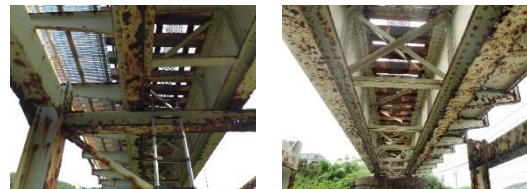
写真-1 桁欠食状況（左：A橋、右：B橋）
