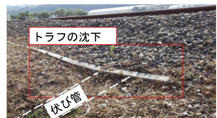
写真1 地点②B-B' 測線で確認されたトラフの沈下
