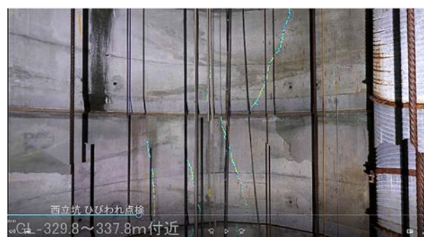
図-5 ひび割れ点検結果の3次元動画表示
