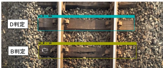
図4 木まくらぎの検出と劣化度判定の結果例
