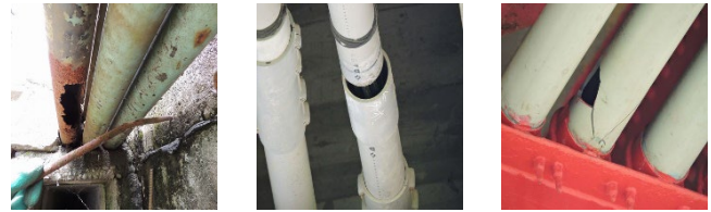
図 1 変状例(左から穴あき・外れ・亀裂)
