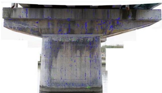
図-4 損傷・汚れの多い橋脚の検出結果
