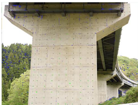
図-5 損傷・汚れの少ない橋脚の検出結果
