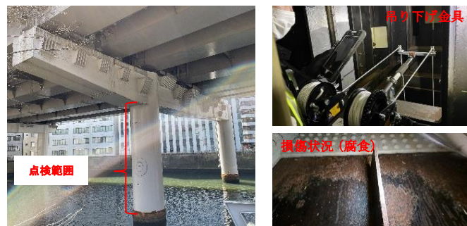
写真-3 鋼製橋脚柱内部の点検状況と損傷状況
