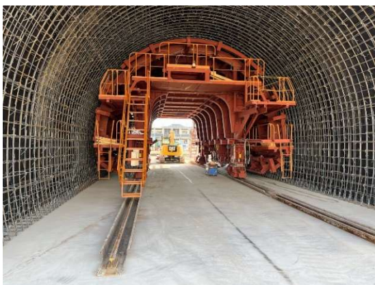
写真-1 覆工実物大実験装置内部
