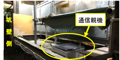
写真-3 電源台車に設置した通信親機
