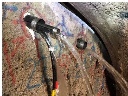
写真2 多量湧水状況
