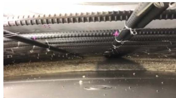
写真-4 覆工コンクリートの流動状況
