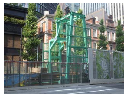
写真-3 地上門型クレーン
