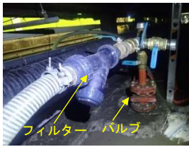
写真-4 地下水排水用バルブ
