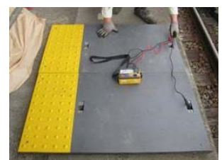
写真-6 絶縁試験
