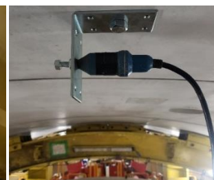
写真-4 地震計 (セグメント内面)
