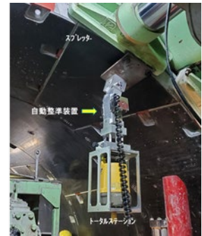
写真-1 坑内自動測量システム
