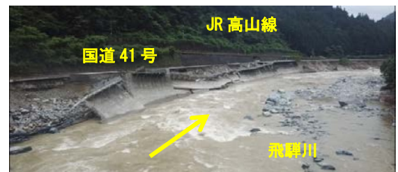
写真-1 国道41号門坂地区の被災状況(7/12撮影)
