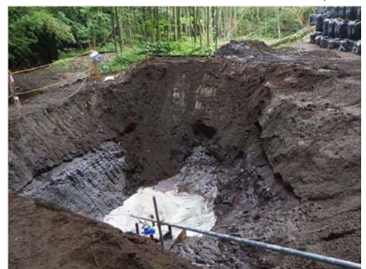
写真-1 掘削面崩壊状況
