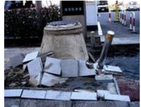
写真-1 汚水用マンホールの隆
