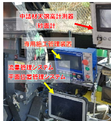
写真 1 施工管理計器
