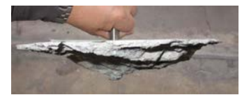
(c) 母材コンクリートのコーン状破壊の一例
