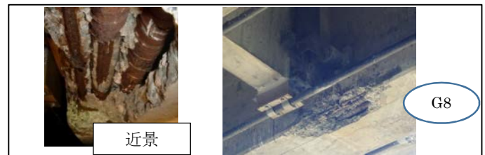
写真1 鋼材腐食による変状
