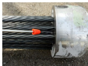
写真-1 破断箇所
