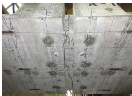
写真-1 ひびわれ発生状況
