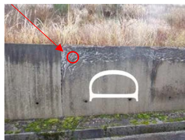
写真 1 L 型 PCa 擁壁のひび割れの発生状況
