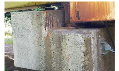
(b) スケーリング劣化事例
