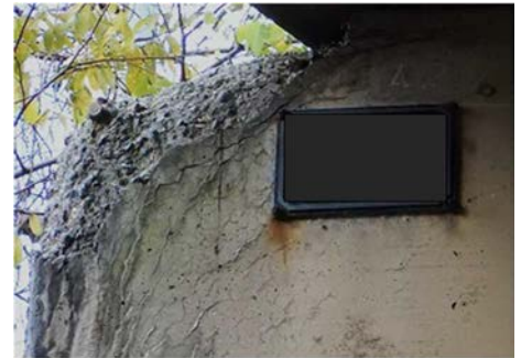
(a) ひび割れを伴う凍害劣化事例
