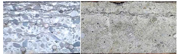
写真-1 実橋床版(左)と実験供試体(右)の水平ひび割れ
