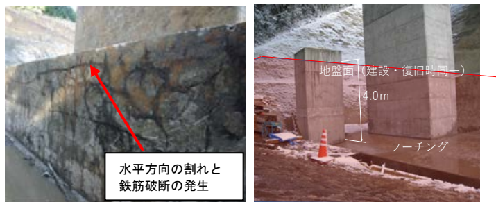
写真-1 ASR が発生したフーチングの状況 (能登有料道路)
