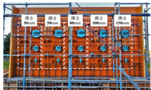
写真-1 模擬欠陥の配置状況
