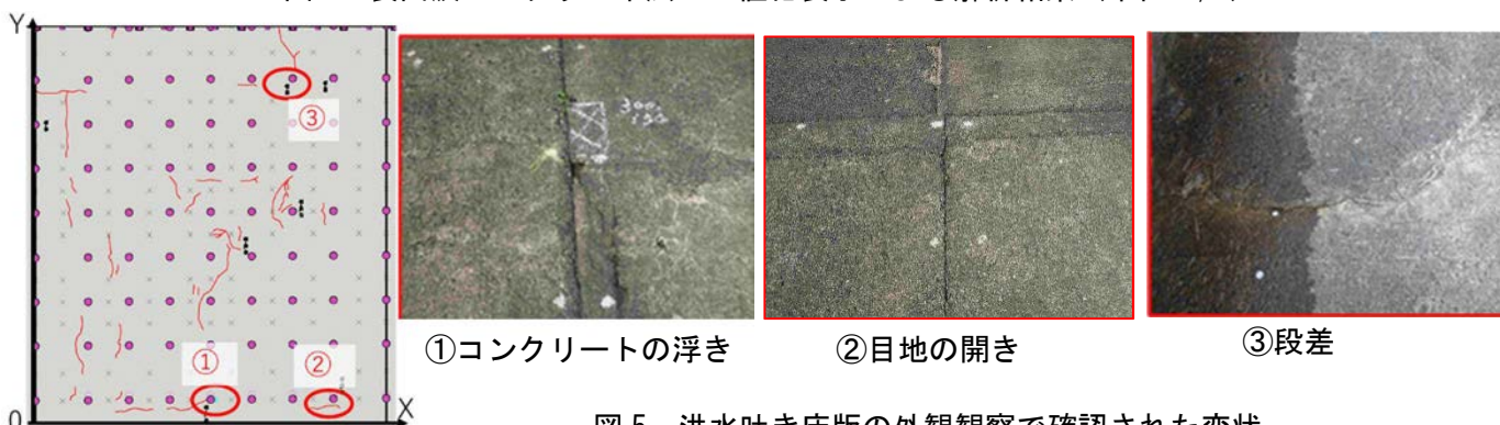
図5 洪水吐き床版の外観観察で確認された変状
