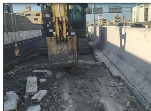
図 6 バックホーによる効率的な路肩コンクリートの撤去状況
