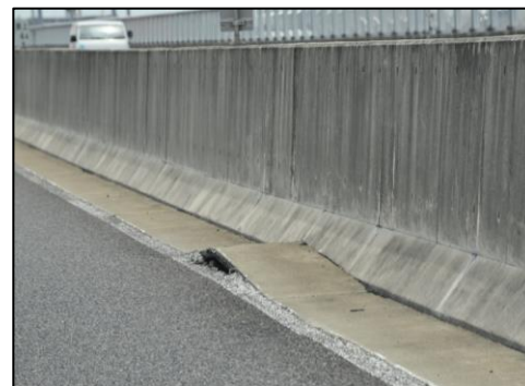
図2 路肩コンクリートのブローアップ
