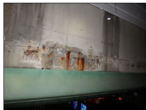
b) 打継ぎ部からの錆汁と漏水跡
