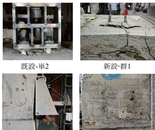
写真-1 破壊状況
