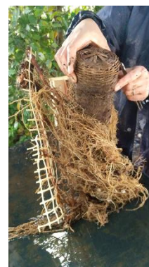
写真5 ブレスパイプに巻き付く根
