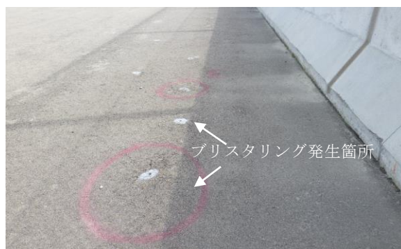
写真-1 ブリスタリング発生状況
