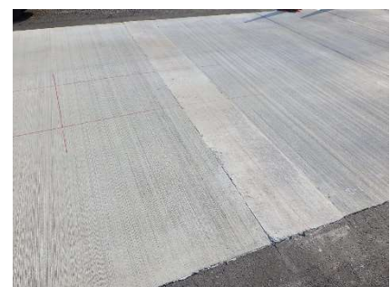
写真-3 供用状況 (35万輪通過後)
